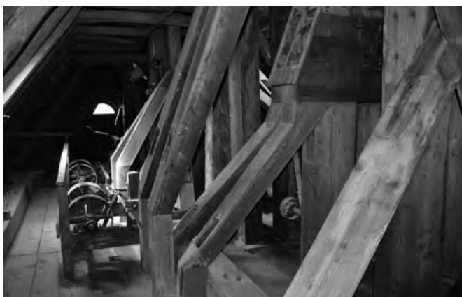
Transmise v podstřeší budovy, 2022 (foto Petra Hrbáčová)
