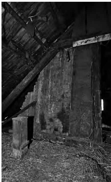
V popředí snímku bedněný průduch nad velkou světnicí, vyústěný do půdního prostoru domu čp. 991 na Benátkách, 2018 (foto D. Alterová)
