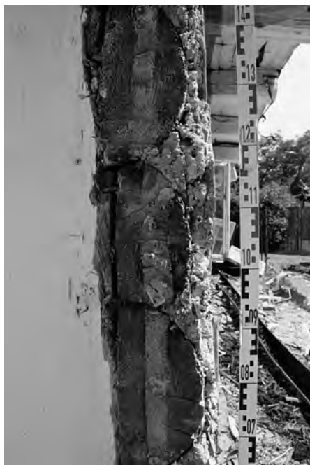
Detail řezu roubenou konstrukcí s povrchovými úpravami jižního průčelí domu čp. 991 na Benátkách, 2018 (foto J. Koudelová)
