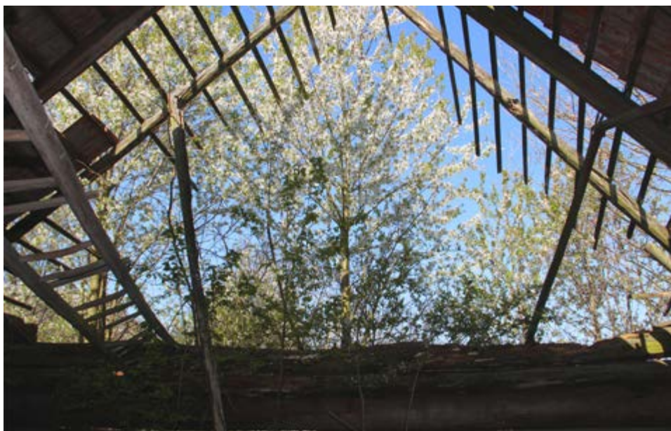
Poškozený západní štít stodoly ve Skaličce při nálezu • 2015
