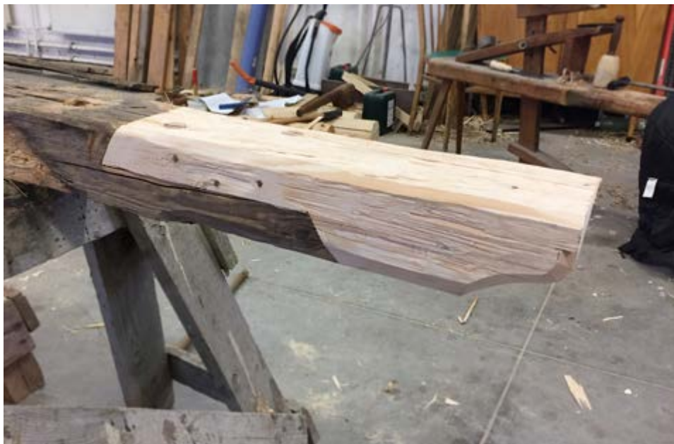
Snaha o opravu poškozeno spodního zakočení krokve
