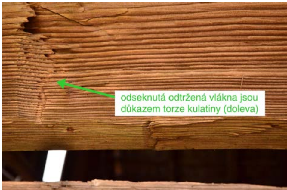
B Detail úpravy líce v místě odtržení vláken, které vzniká při draní stočeného dřeva
