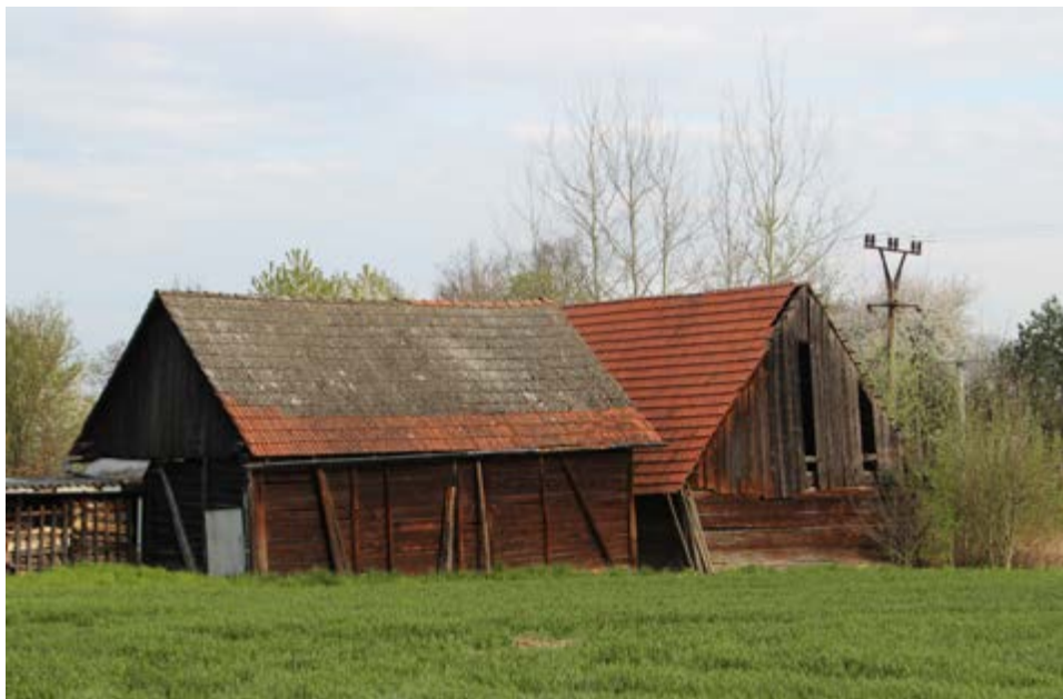
Dvě pozoruhodné stodoly byly během výzkumu v obcích Moravské brány objeveny ve Skaličce • 2015
