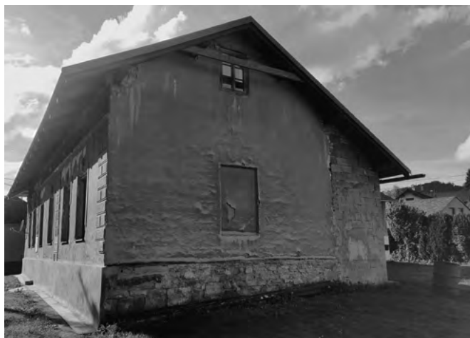
Těžko otvírat diskuzi nad konstrukčními detaily, přesahy a proporcemi střeš, když si stavebník ani neuvědomuje přítomnost okna ve štítě, Palkovice, 2022 (foto Jan Kraut)
