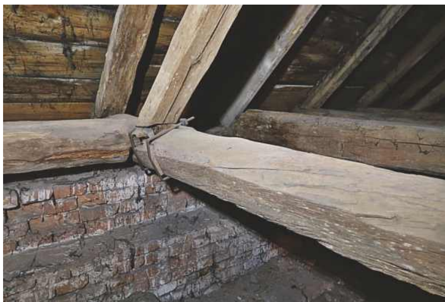
3] Stočení vazného trámu a roztržení v podélné výsušné trhlíně vlivem točitosti a rozvolnění čepovaného spoje vzpěry
