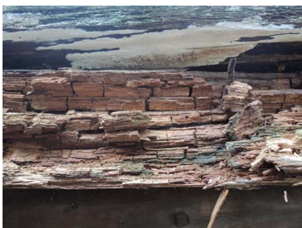
Obr. 18 Poškozený trám č. 7 v místě severního zhlaví
