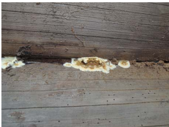
Obr. 16 Poškozený trám č. 6 v místě západního zhlaví
