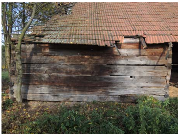
Obr. 4 Jižní stěna západní části stodoly
