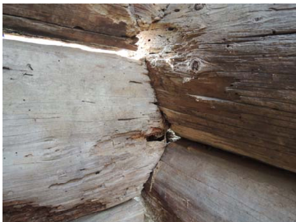
Obr. 14 Poškozený trám č. 2 v místě západního zhlaví
