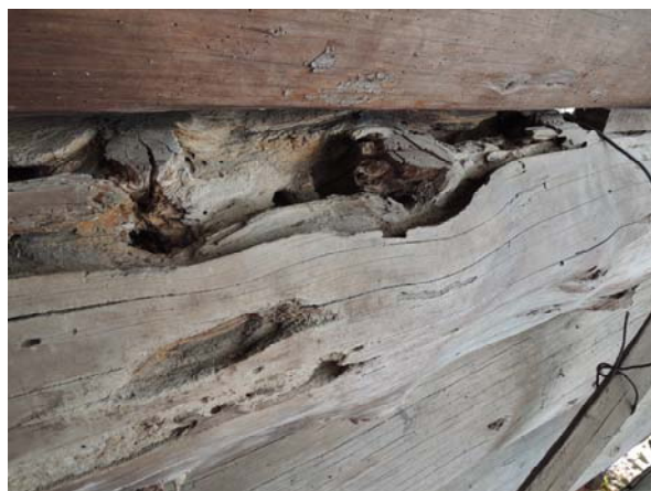
Obr. 15 Poškozený trám č. 5 v místě západního zhlaví
