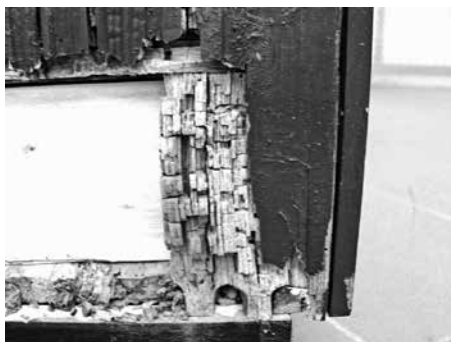
Detail poškození dřevomorkou.
